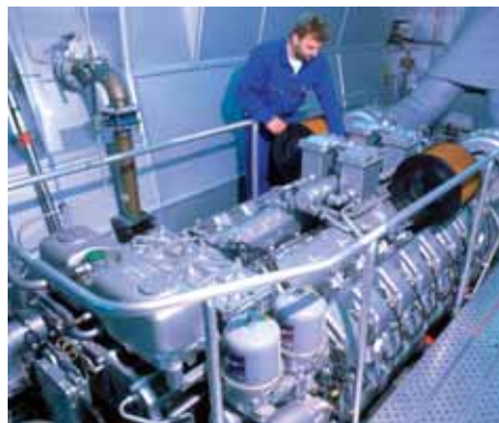
Ein Techniker wartet den Dieselmotor im Maschinenraum eines Schiffes.
